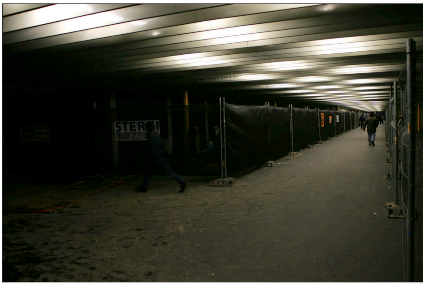
Grusel-Unterführung: Seit der Umbau begonnen hat, ist die Bahnhofspassage noch schlimmer als vorher.
